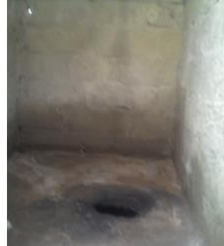
Photo 6 : Trou d'une latrine
