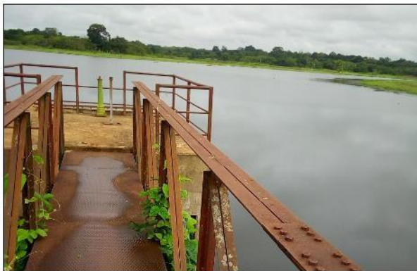
a ) Dispositif pour l'exploitation du barrage de retenue d'eau pour l'adduction d'eau potable dans la commune de Katiola
