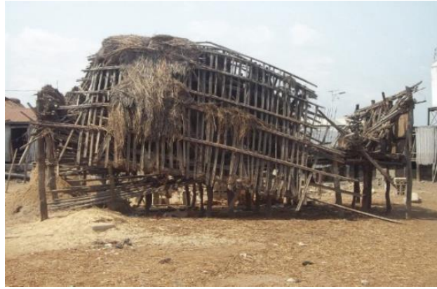
Photo 7 : Maison en bois sur pilotis effondrée (Coord. X=432865 ; Y=714825)
