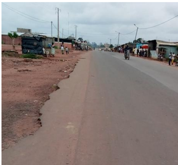
Photo 1 : Dégradation du trottoir à Bonon
