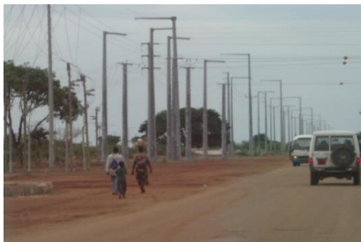
Photo 4 : Vue partielle des lignes de haute tension alimentant le pompage du brut
