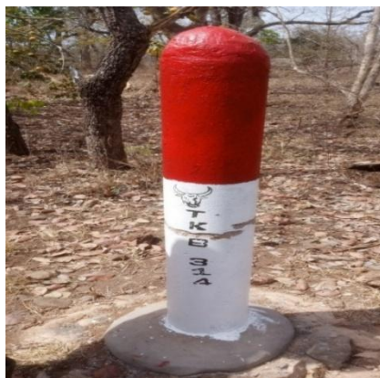
Photo 1 : Balise en état de dégradation à Kadarvogo dans la région du Tchologo Prise de vue : GRAH, 2024
